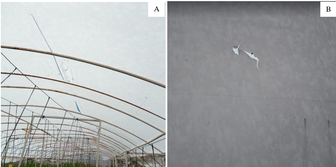
Fotografía 2. A) Cubiertas plásticas del túnel 2 rotas y B) Cubiertas plásticas del invernadero 3 rotas.
