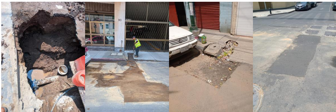
Fotografías 9-12 Agua potable calle Fresas.
