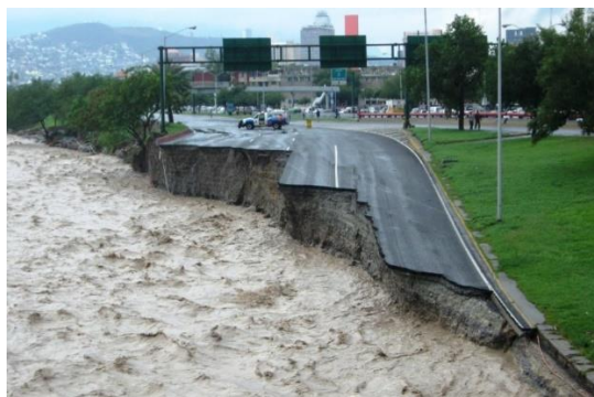
Imagen 8: Foto Daños en el estado de Nuevo León provocados por el huracán Alex. 11
