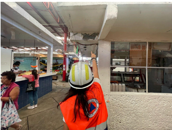
Imagen 5: Analizando afectaciones superficiales. Fotografía tomada por personal de Protección Civil
