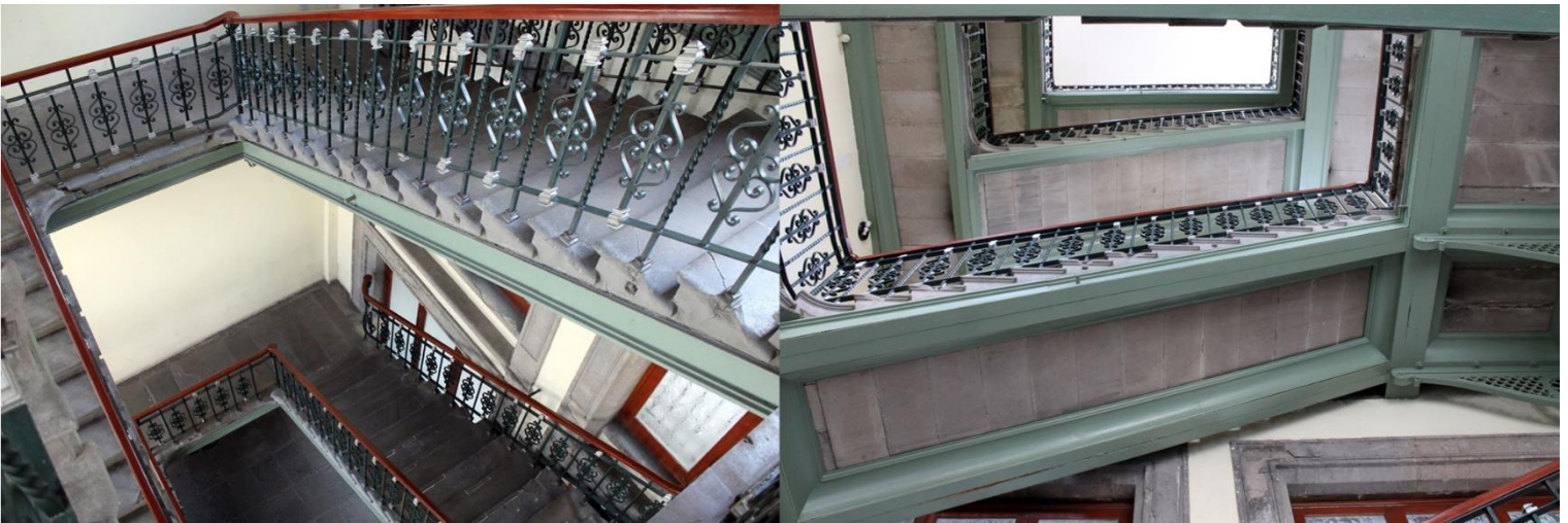
Fotografía de vista general de las escaleras y los barandales Recinto a Juárez, Palacio Nacional Tomadas por: Mtro. Ricardo Muñoz Nájera
