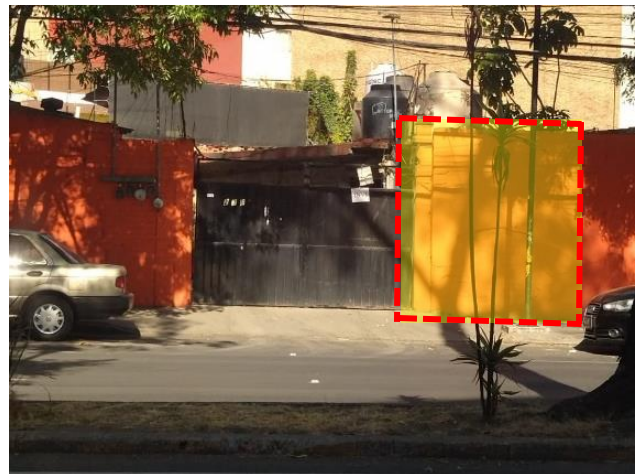
Riesgo estructural en fachada
