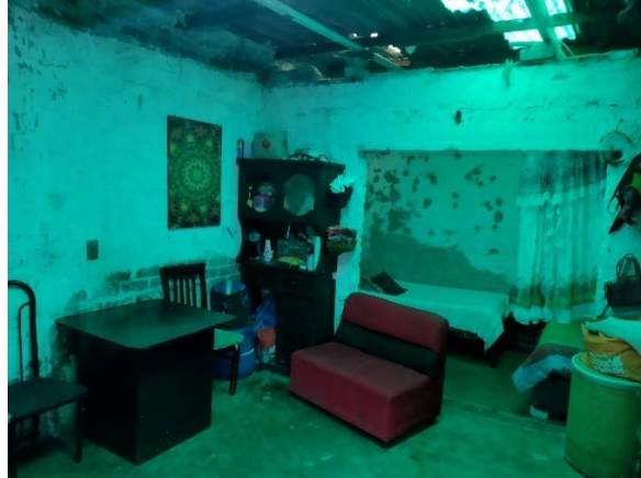
Interior de la vivienda, presencia de humedad en muros.
