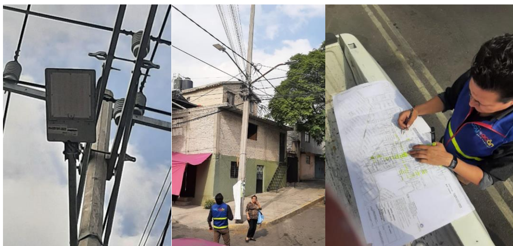
Fig. 6 Evidencia de levantamiento de alumbrado público. Autoría propia.
