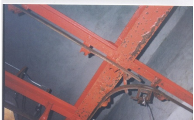
RIELES DE LAS CANALES OXIDADAS.
