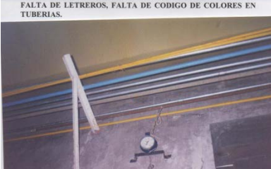
EN GENERAL SE OBSERVO FALTA DE MANTENIMIENTO.
