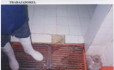
DETERIORO, OXIDACION Y FALTA DE MUROS REDONDEADOS DEL ACCESO PRINCIPAL (VADO SANITARIO).
