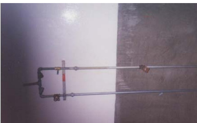
FALTA DE LETREROS, FALTA DE CODIGO DE COLORES EN TUBERIAS.
