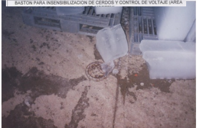
COLADERA EN FRIGORIFICO OXIDADA.
