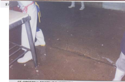
SE OBSERVA ENCHARCAMIENTO.
