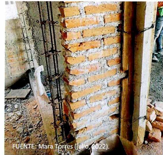
Imagen 3. Juntas en muros de mampostería en la obra del módulo "A" mayores a 12 mm.
