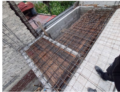
Imagen 18.- Foto de armado de losa maciza para el baño y el núcleo de escaleras.
