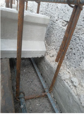
Imagen 17.- Foto de viga empotrada a 7 cm de la cadena.
