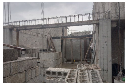
Imagen 13.- Foto de columnas y muros de planta baja más armados de cadena de cerramiento.
