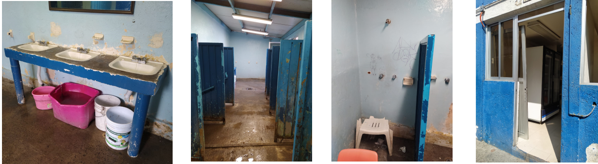
Figura 1,2 y 3: Baños Hombres con necesidad de mantenimiento Figura 4: Puerta dañada de acceso a insumos
