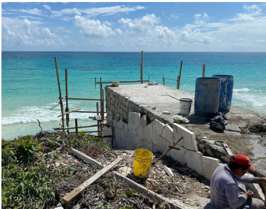
Figura 2. Avance de obra en Parque El Jaguar, sección Riscos Norte. (Febrero, 2024). Foto tomada por el autor.
