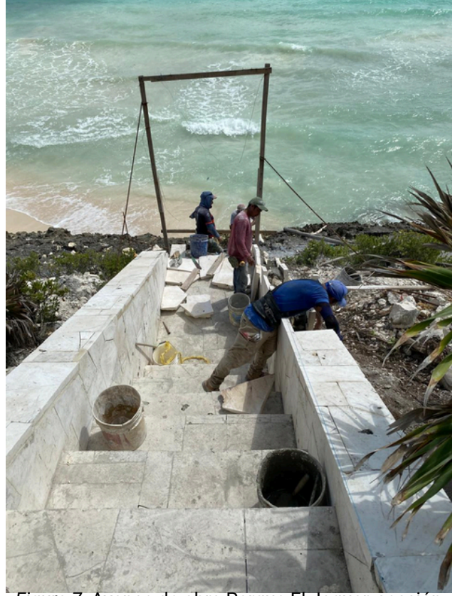
Figura 7. Avance de obra Parque El Jaguar, sección Riscos Norte. Tulum. (Febrero, 2024). Foto tomada por el autor.
