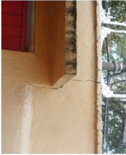
Jardín de niños: Cua 20-30 Barras perimetrales fracturadas
