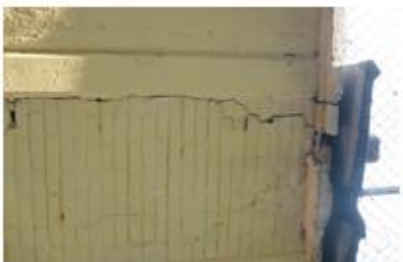
Escuela Primaria: Kuwait Bancos perimetrales fracturados
