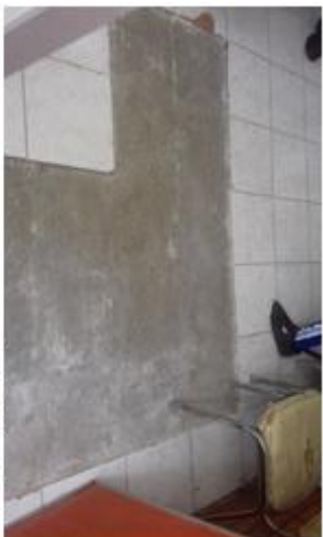
Secundaria Manuel Serrate Falta de losetas
