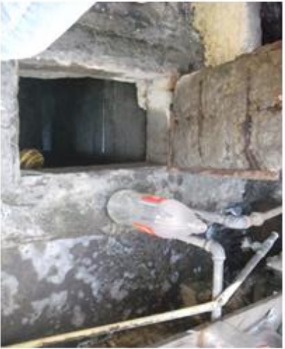
Escuela Primaria: Kuwait Módulo de la cisterna
