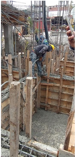
Anexo 8. Madrigal L. Adalid, 2024, fotografía de supervisión de cajón de cimentación "La Cruz".
