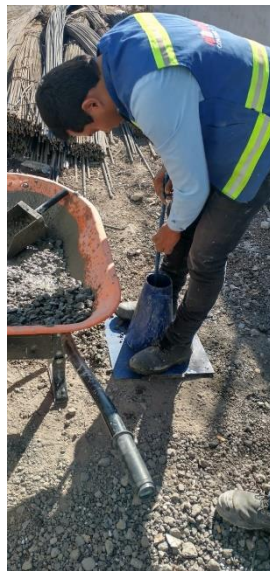
Anexo 4. Madrigal L. Adalid, 2024, fotografía de prueba de revenimiento en "Leyes de Reforma".
