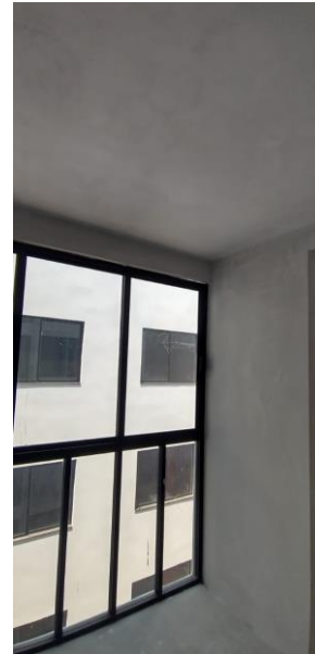
Anexo 9. Madrigal L. Adalid, 2024, fotografía de supervisión acabado con yeso "Mar Caspio".
