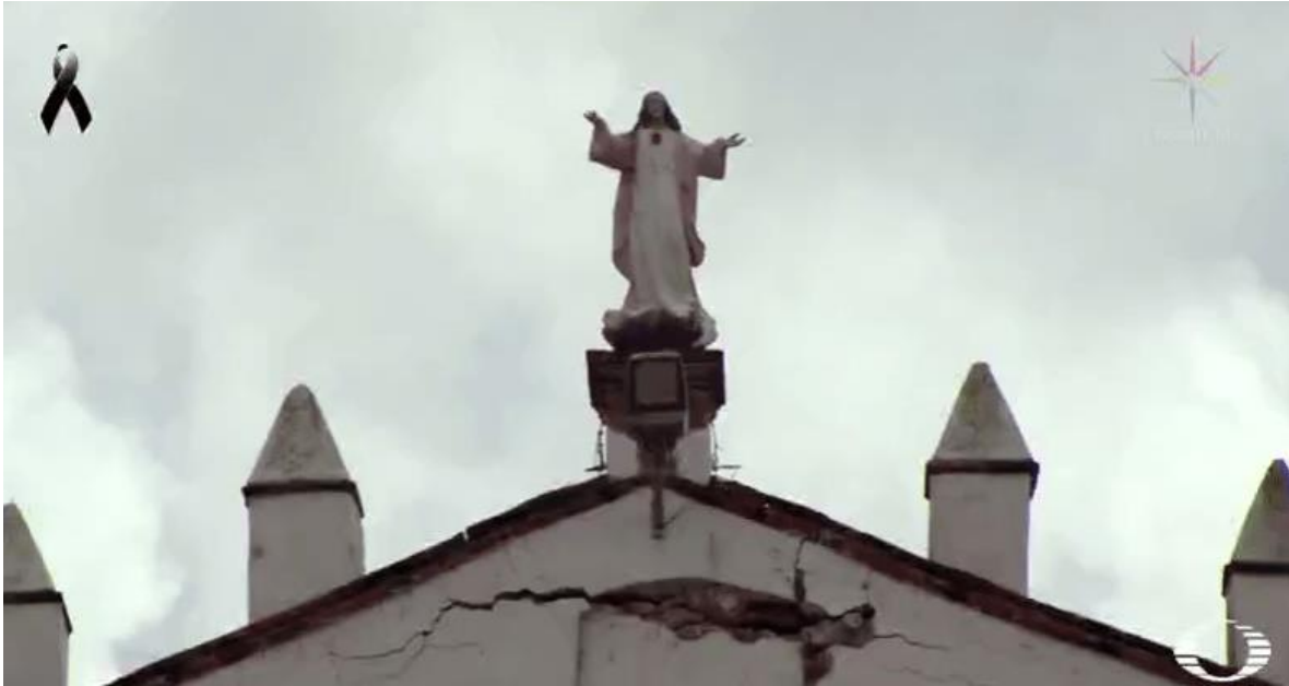
Fotografía 4a. Iglesia afectada en Tlatempa, Estado de México, por sismo del 19 de septiembre (Noticieros Televisa).
