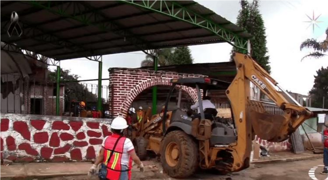
Fotografía 2a. Daños en capilla de Tlatempa, Estado de México (Noticieros Televisa).
