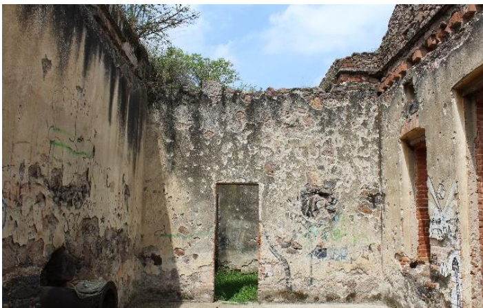
IMAGEN 5. Deterioro interior provocado por vandalismo y saqueo de materiales y exposición a la intemperie.
