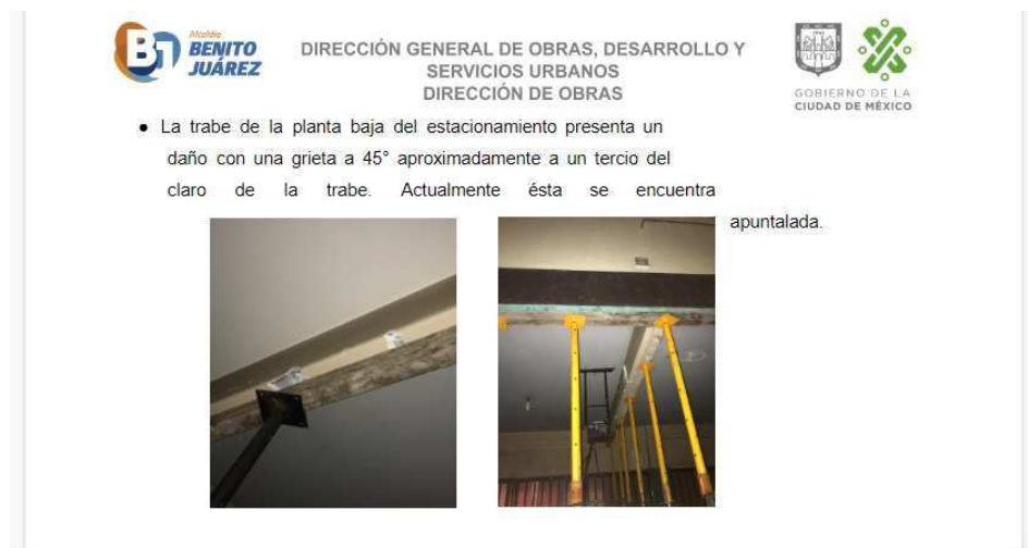
Imagen 14. Documento redactado sobre las condiciones estructurales del edificio en la calle Filipinas 178. 1
