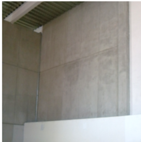
ESTACION ATLALILCO: FALTA PINTURA EN ANTEPECHO DE LAS ESCALERAS DEL ACCESO SUR
