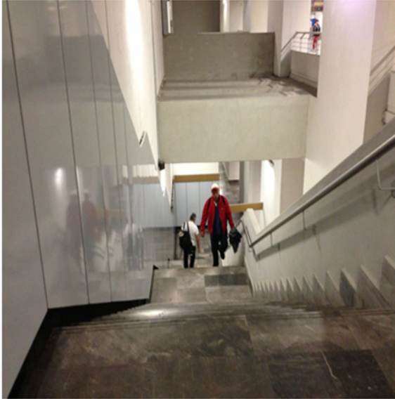
ESTACION ERMITA: FALTA PASAMANOS EN LAS ESCALERAS FIJAS DE ANDEN 2.
