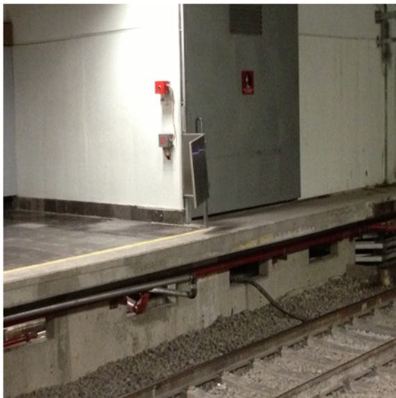
ESTACION MEXICALTZINGO: PUERTA DE SEGURIDAD AVERIADA UBICADA EN PIE DE ANDEN 2 Y FALTA EXTINTOR
