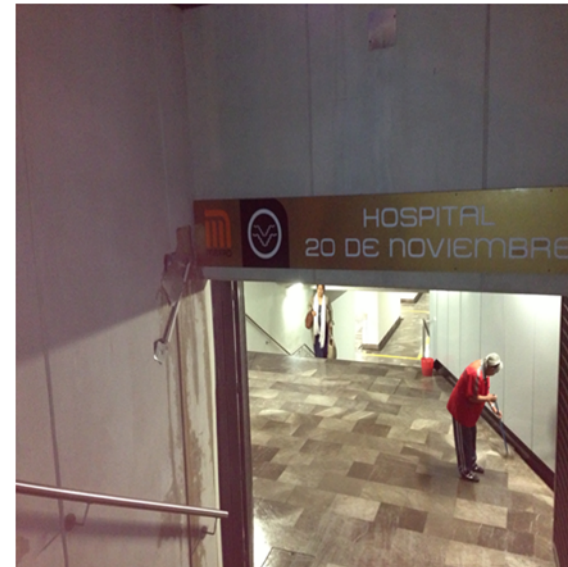
ESTACION HOSPITAL 20 DE NOVIEMBRE : CON FILTRACIONES EN LOS ACCESOS
