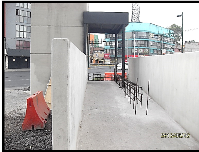
ESTACION MIXCOAC: FALTAN LOS ACABADOS EXTERIORES, NO CUENTA CON ALUMBRADO ELEVADOR # C3-E
