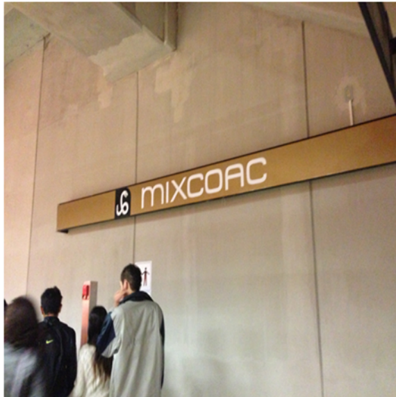
ESTACION MIXCOAC : FALTAN TERMINADOS EN LA PARED DE ANDEN 1
