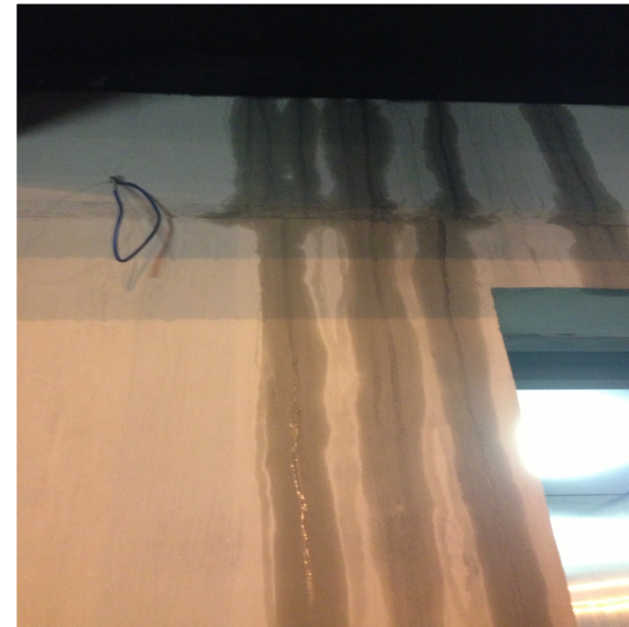
ESTACION MIXCOAC : FILTRACIONES EN ANDENES Y CABLES SUELTOS EN VIA 1
