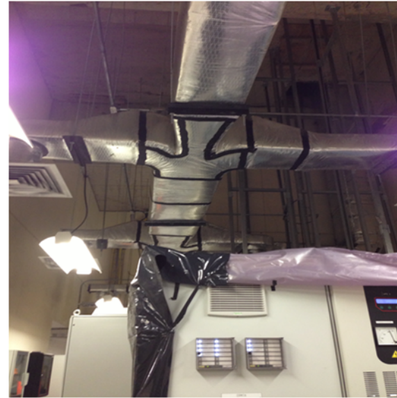
ESTACION ERMITA: LOCAL TÉCNICO (EL EQUIPO PDC CUBIERTO CON PLASTICOS POR LA FILTRACIÓN DE AGUA) ORIGINADA EN EL LOCAL DE VENTILACIÓN.
