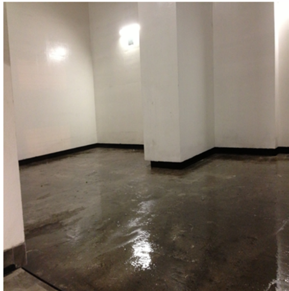
ESTACION PARQUE DE LOS VENADOS: CON FILTRACIONES EN LOS ANDENES
