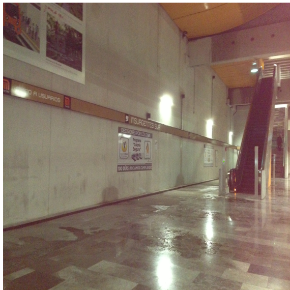
ESTACION INSURGENTES SUR: CON FILTRACIONES EN TODA LA ESTACION
