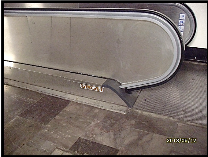
ESTACIÓN ATLALILCO: NO FUNCIONAN LA BANDA TRANSPORTADORAS # ATLAM - 6
