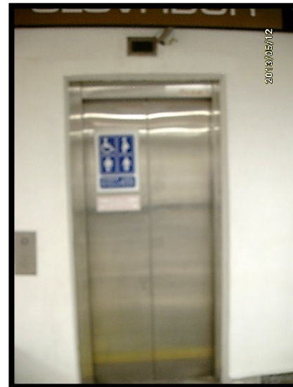
ESTACION ERMITA: NO FUNCIONA EL ELEVADOR ERM P-3E
