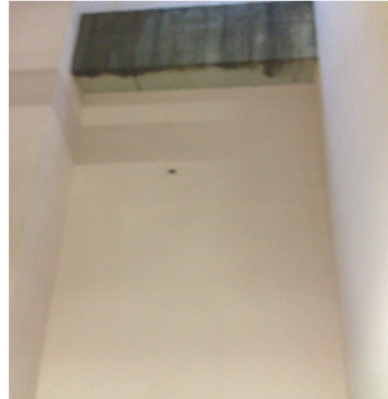
ESTACION PARQUE DE LOS VENADOS : CON FILTRACIONES EN PASILLOS
