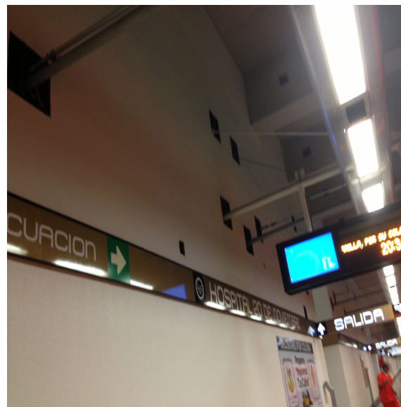
ESTACION HOSPITAL 20 DE NOVIEMBRE: FALTA CONTACTOS EN LOS ANDENES
