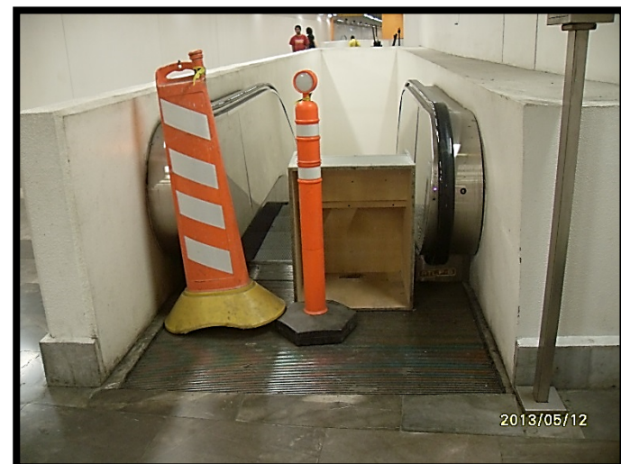
ESTACIONES ATLALILCO: NO FUNCIONA LA ESCALERA ELECTRICA ATL P-6
