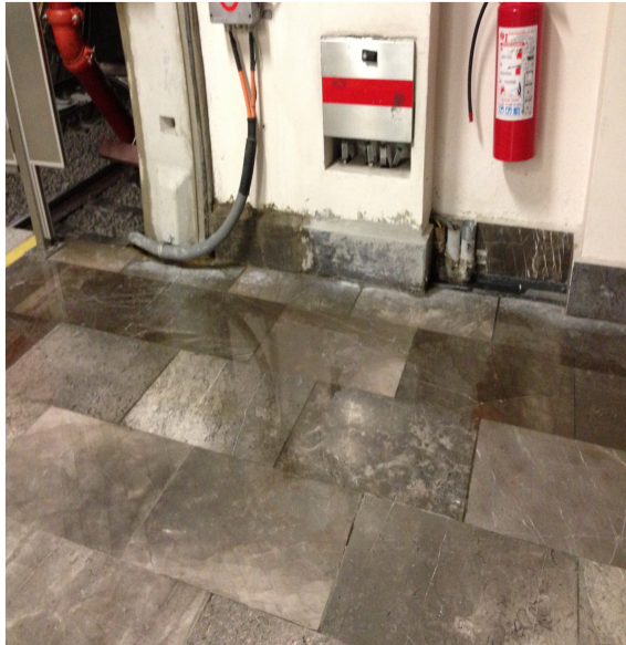
ESTACION PARQUE DE LOS VENADOS: CON FILTRACIONES EN CABECERA DE ANDEN VÍA 2
