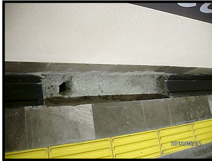
ESTACION HOSPITAL 20 DE NOVIEMBRE: FALTA LA INSTALACION DEL ZOCLODREN
