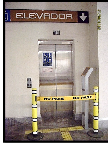
ESTACION ERMITA: CONTINUA SIN INSTALACION EL ELEVADOR ERM 1-1E
