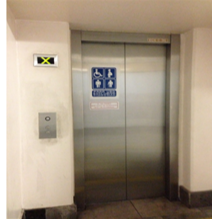
ESTACION EJE CENTRAL: ELEVADOR No. C3- E NO FUNCIONA
