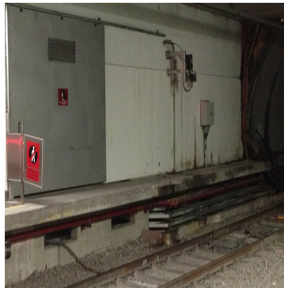
ESTACION MEXICALTZINGO: PIE DE ANDEN 1, CON FILTRACIONES
