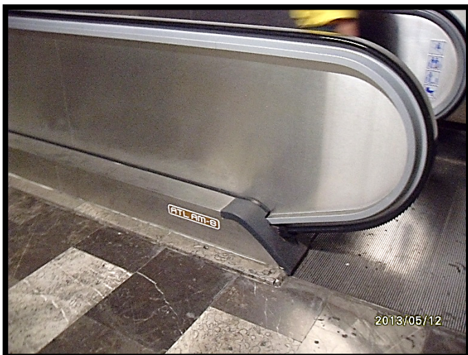
ESTACIÓN ATLALILCO: NO FUNCIONAN LA BANDA TRANSPORTADORAS # ATLAM - 8
