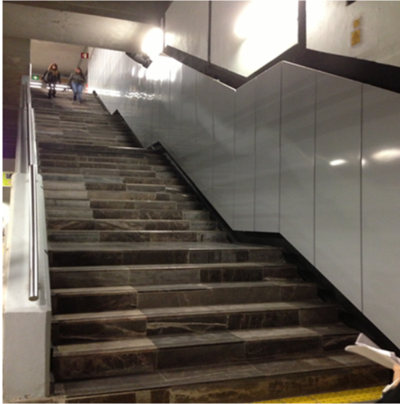
ESTACION MEXICALTZINGO: FALTA PASAMANOS EN ESCAELERAS FIJAS DE ANDEN 1 Y ANDEN 2
