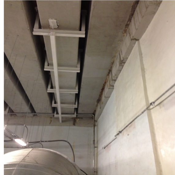
ESTACION ERMITA: LOCAL DE VENTILACIÓN CON FILTRACION DE AGUA, AFECTANDO INSTALACIONES
