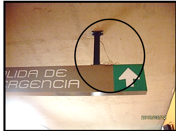
ESTACIÓN ATLALILCO: FALTA LA INSTALACION ELECTRICA EN LA SEÑALIZACION INFORMATIVA (LUMINOSA)
