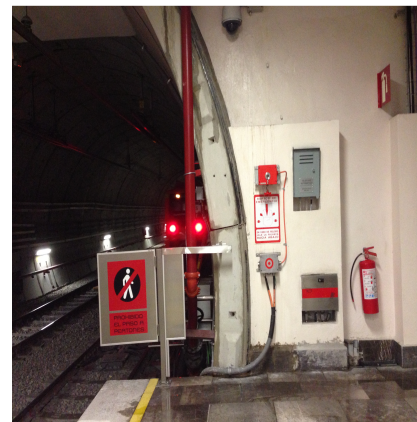
ESTACION PARQUE DE LOS VENADOS : FALTA INSLALAR GABINETE A LOS EXTINTORES UBICADOS EN EL ANDÉN EN TODA LA LÍNEA.
