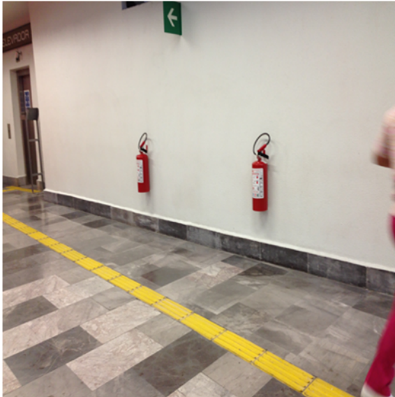
ESTACION ERMITA: FALTAN GABINETES DE EXTINTOR, EN PASILLOS DE CORRESPONDENCIA Y EN CABECERA DE ANDÉN 1
