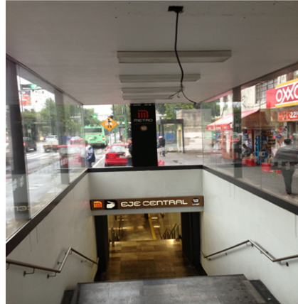
ESTACION EJE CENTRAL: CON CABLES SUELTOS EN EL ACCESO DE LA ESTACION
