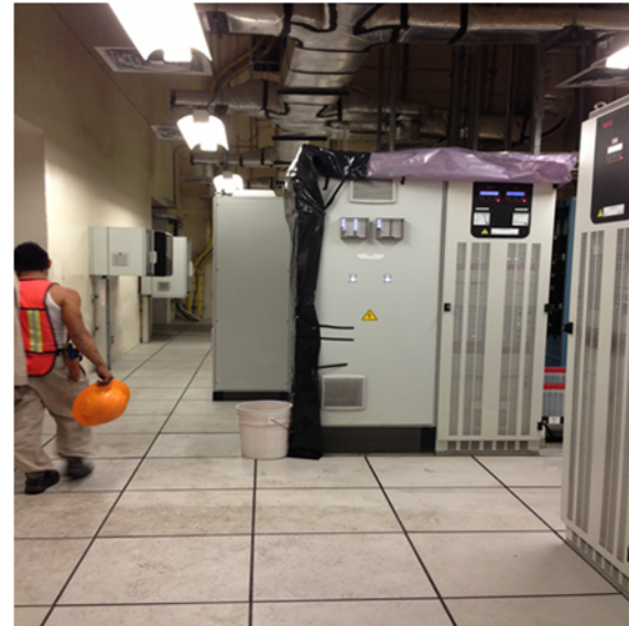
ESTACION ERMITA: (EL EQUIPO PDC CUBIERTO CON PLASTICOS POR LA FILTRACIÓN DE AGUA) ORIGINADA DEL LOCAL DE VENTILACIÓN INTERIOR DEL LOCAL TÉCNICO DE PIE DE ANDÉN 2
