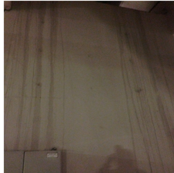
ESTACION ERMITA: LOCAL DE VENTILACIÓN CON FILTRACION DE AGUA, AFECTANDO INSTALACIONES UBICADO EN PIE DE ANDÉN 1
