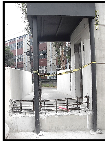
ESTACION MIXCOAC: FALTAN LOS ACABADOS EXTERIORES, NO CUENTA CON ALUMBRADO ELEVADOR # C3-E
