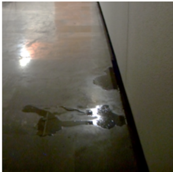
ESTACION ATLALILCO: PASILLO DE CAMBIO DE ANDEN CON FILTRACIONES ATLALILCO: SALIDA DE EMERGENCIA INICIO DE PASILLO DE CORRESPONDENCIA CON FILTRACIONES
