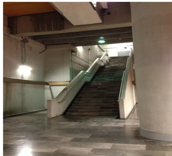
ESTACION INSURGENTES SUR: CON FILTRACIONES EN TODA LA ESTACION
