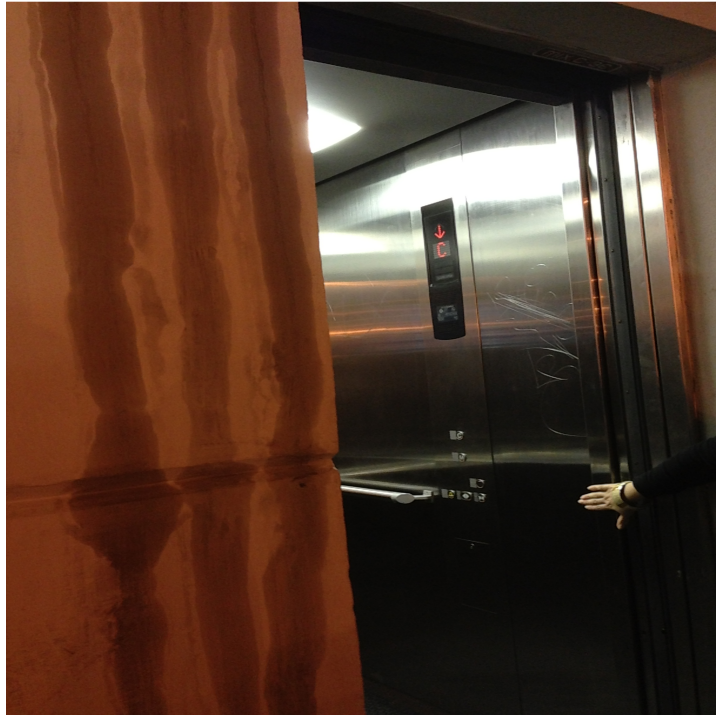
ESTACION MIXCOAC: CON FILTRACIONES DE AGUA
