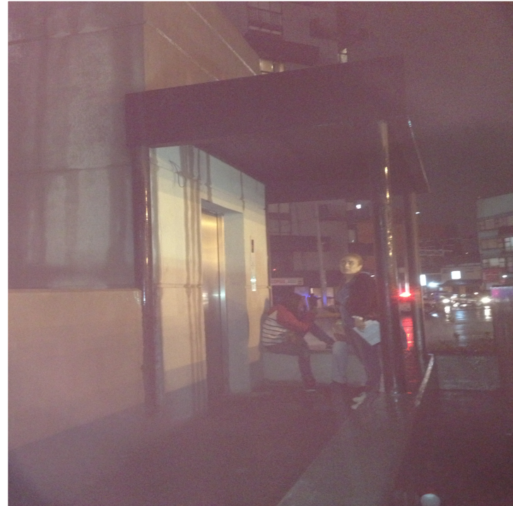
ESTACION MEXICALTZINGO: FALTA ACABADOS EN EL ELEVADOR DEL ACCESO A LA CALLE
