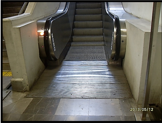
ERMITA: NO FUNCIONA LA ESCALERA ELECTRICA ERM P-9
