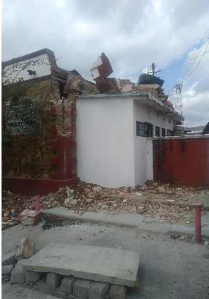
Fotografía 24. Daño en baños
