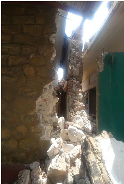
Fotografía 26. Desprendimiento de muros
