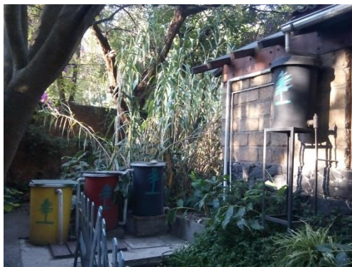
Sistema de captación y purificación de agua pluvial
