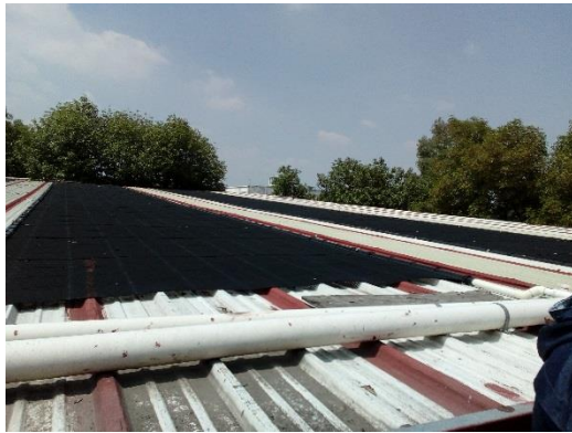
Fig. 11 Paneles solares en la azotea de la alberca Bicentenario.
