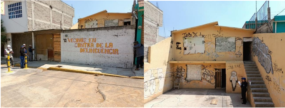
Img_12_fachada interna y externa de inmueble en riesgo 1_Arq.Rosalia
