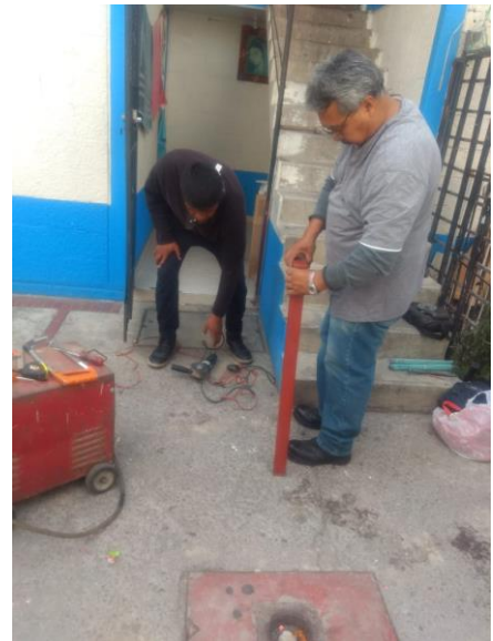
Imagen 1. Supervisión de obra interna, unidad habitacional Manuel M. López III, Tláhuac, CDMX.
