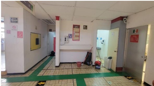
Fig. 15. Núcleo sanitario marcado en planta, pero actualmente designado como depósito de residuos tóxicos
