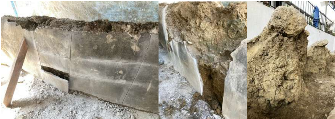
Figura 31. Partes del proceso en el que se fue retirando el concreto en distintos puntos. Se puede observar el grado de deterioro por dentro de las capas.
