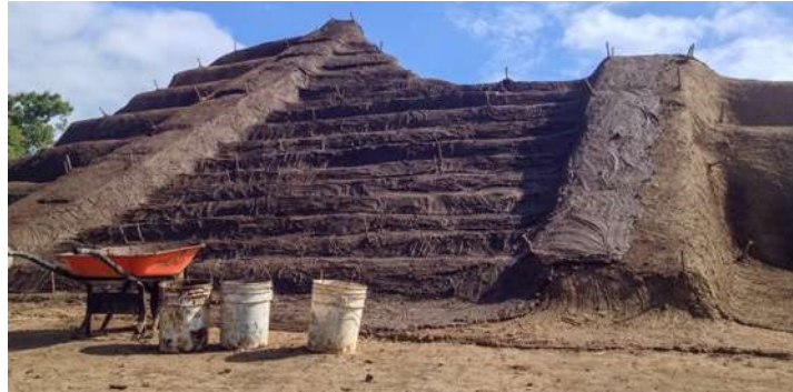
Figura 9. Aplicación de capas de sacrificio en el basamento principal del sitio La Joya, Veracruz.
