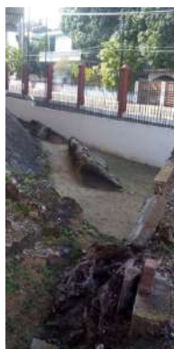
Figura 27. Detalle donde se observan las plantas y el hongo negro que crecía en los elementos de argamasa a causa de la humedad, las raíces del higuerón sobre la escalinata y el confinamiento del sitio por debajo del nivel de calle. Foto por el custodio del sitio Miguel Hernández, 2021.
