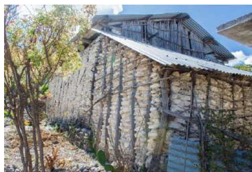
Figura 3. Casa construida con madera y bloques de tierra cortada, unidos con mortero de tierra. Tzimol, Chiapas.
