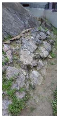
Figura 28. Detalle del Talud I en donde se observa el crecimiento de la vegetación.
