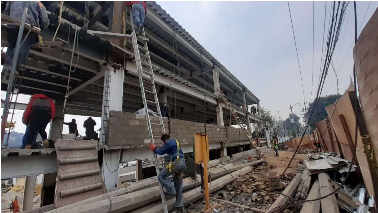
Visita de obra del día 07 de Diciembre de 2020, continuación de muros de block en fachada.
