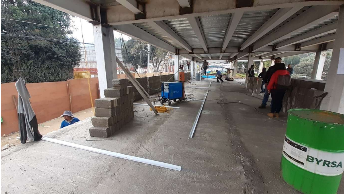
Visita de obra del día 07 de Diciembre de 2020, colocación de muros divisorios de tablaroca.
