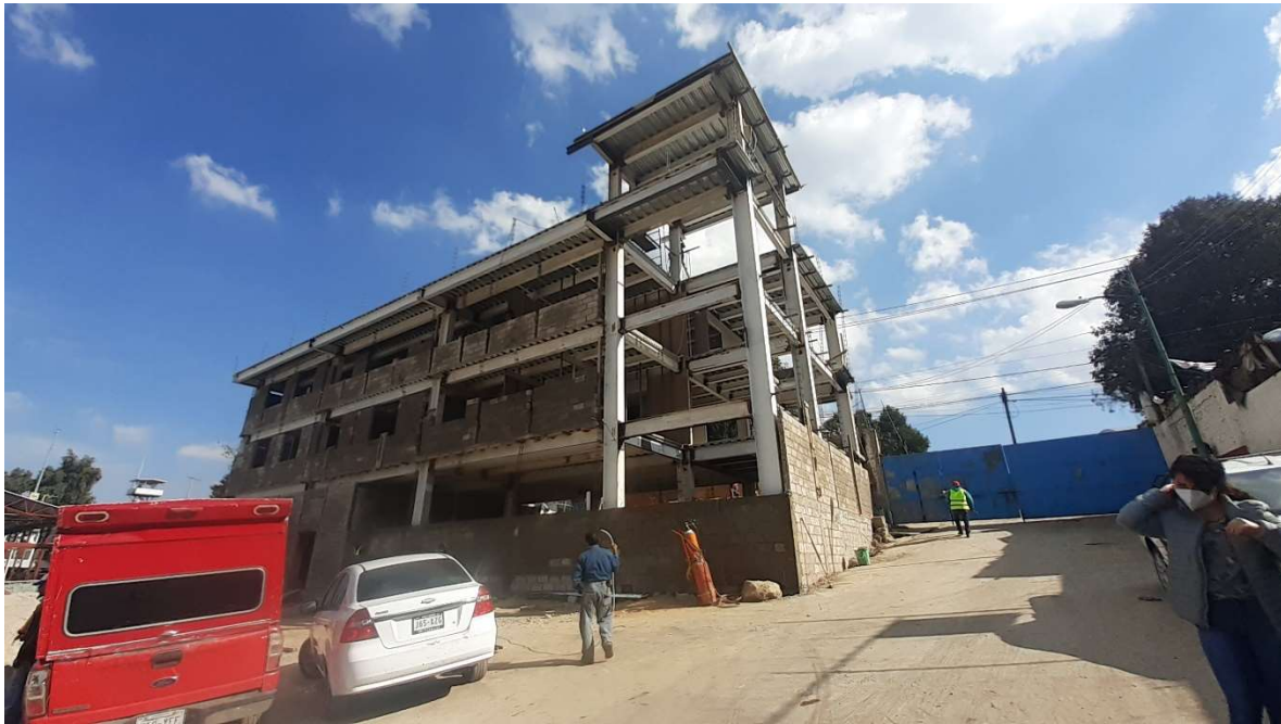
Visita de obra del día 14 de Diciembre de 2020, terminación de muros de mampostería en fachadas.
