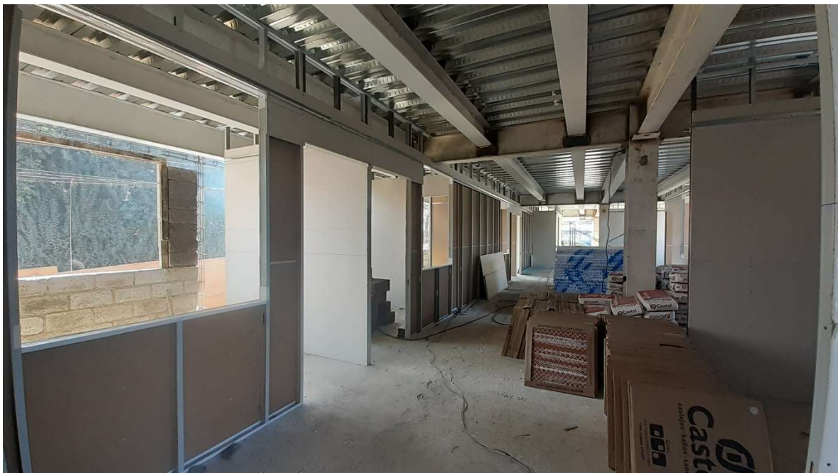
Visita de obra del día 14 de Diciembre de 2020, terminación de muros divisorios de tablaroca.
