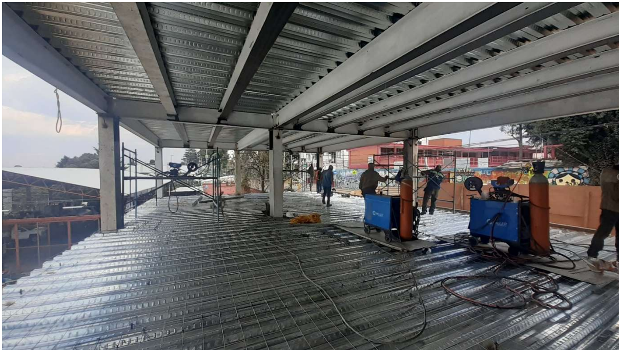
Visita de obra del día 02 de Diciembre de 2020, tendido y colocación de losacero.
