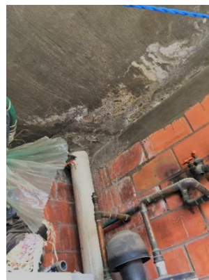
Figura 12. Humedad y salitre en el patio de servicio. Fuente: Aguilar, A. (2023)
