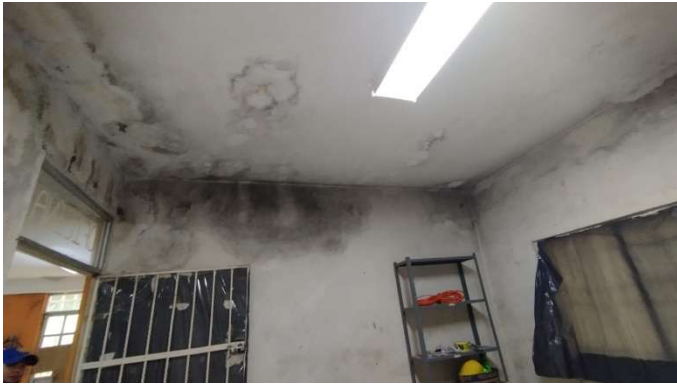
Ilustración 24. Humedad en losa. Toma propia.
