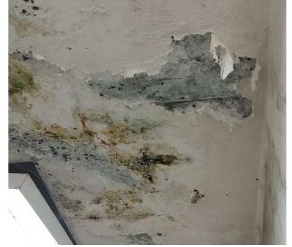
Ilustración 26. Filtración en losa. Toma propia.
