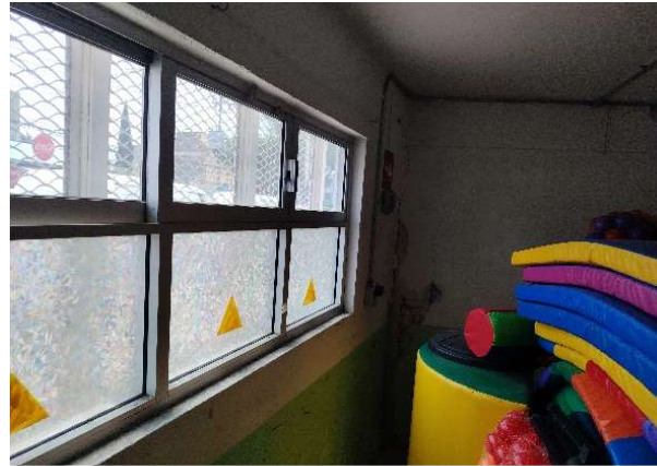
Ilustración 17. Aula con daño estructural. Toma propia.
