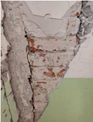
Ilustración 16. Aula con daño estructural. Toma propia.
