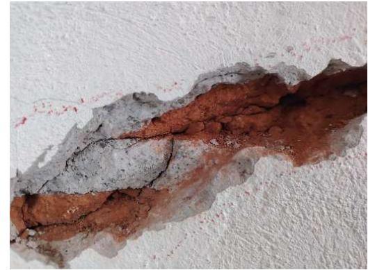
Ilustración 18. Aula con daño estructural. Toma propia.
