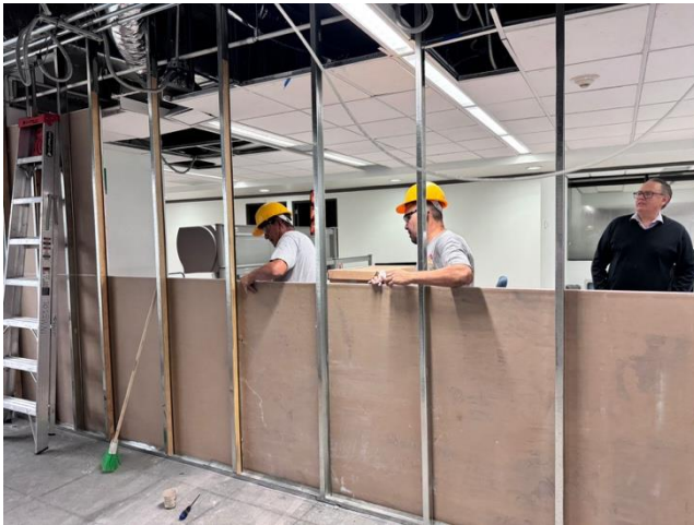
Imagen 1: Coordinación de los trabajos de adecuación para el desarrollo del proyecto TNN33 - Biblioteca. CNBV - Comisión Nacional Bancaria y de Valores, CDMX.
