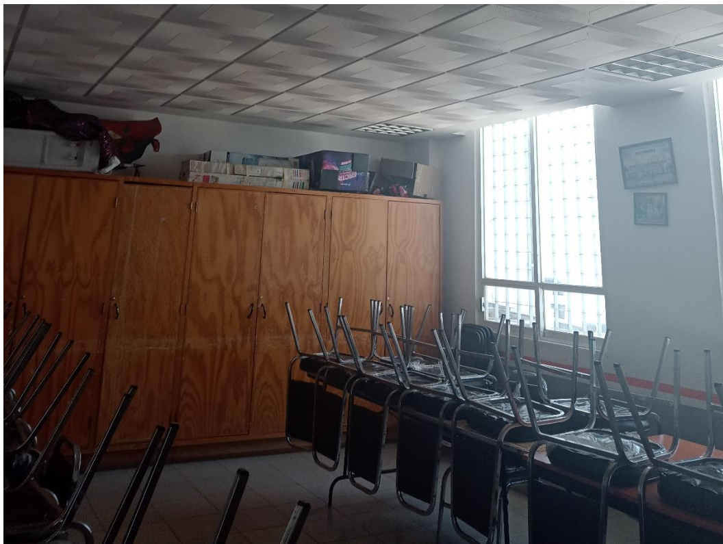
Filtración de agua en plafones del salón de usos múltiples
