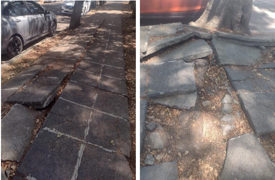
Imagen 15. Ruptura en banqueta por raíces de los árboles.
