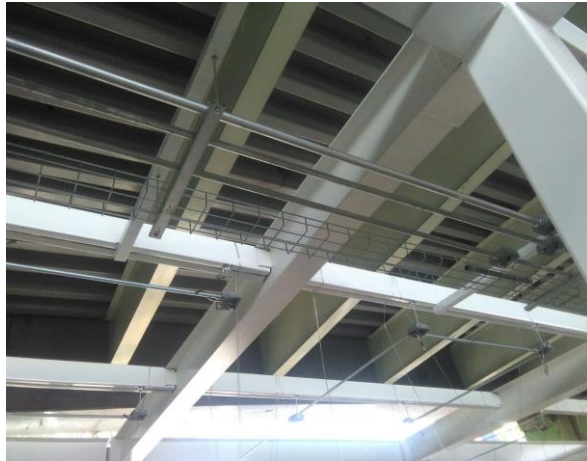
Imagen 10.- Canaletas para paso de instalaciones en territorial taxqueña
