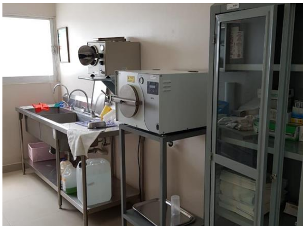
Cuarto de esterilización. Centro de Salud Peña Blanca. Fuente: Toma propia, 2022.
