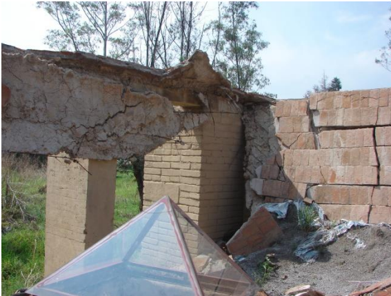
Derrumbe de techumbre
