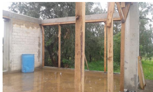
Aún no se ha descimbrado parte de las traves
