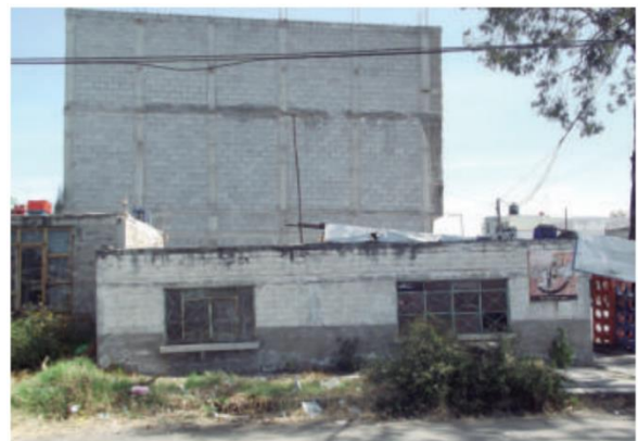
Ilustración 8: Hundimiento de vivienda en c. Montes Caucaso. Fuente: Atlas de Peligros y Riesgos de la Ciudad de México, Delegación Tláhuac.
