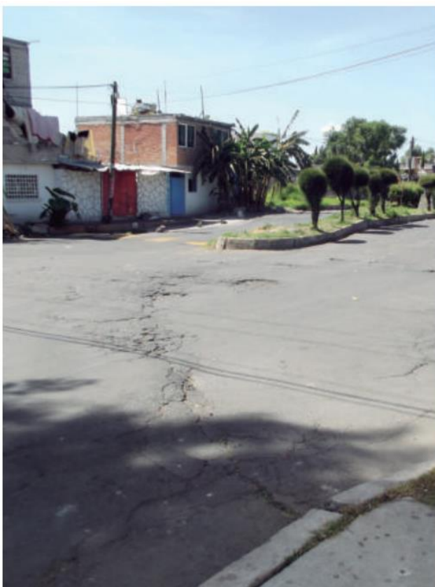
Ilustración 5: Fractura en calle mar de las lluvias. Fuente: Atlas de Peligros y Riesgos de la Ciudad de México, Delegación Tláhuac.
