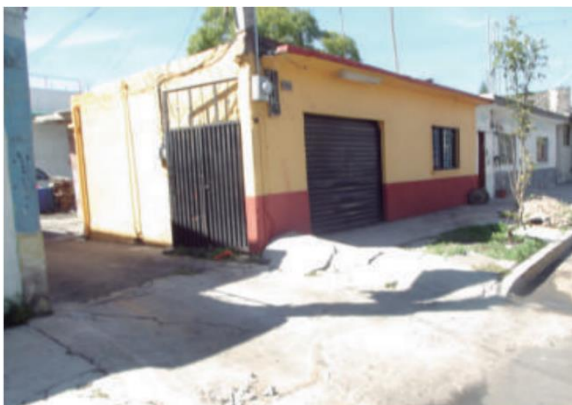
Ilustración 9: Daños en la acera y el muro de la vivienda. C. Lago de los sueños. Fuente: Atlas de Peligros y Riesgos de la Ciudad de México, Delegación Tláhuac.
