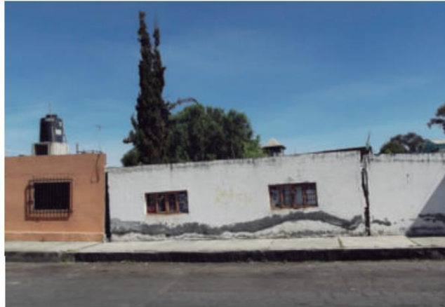
Ilustración 21: Hundimiento de vivienda y separación de sus muros C. Jesús González Ortega. Fuente: Atlas de Peligros y Riesgos de la Ciudad de México, Delegación Tláhuac.
