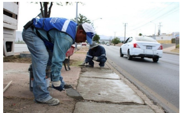
6.-Fotografía de fuente propia. Obra pública realizada en el municipio de Ixtapaluca, Edo. Mex. Año 2021. "reparación y colocación de guarniciones".
