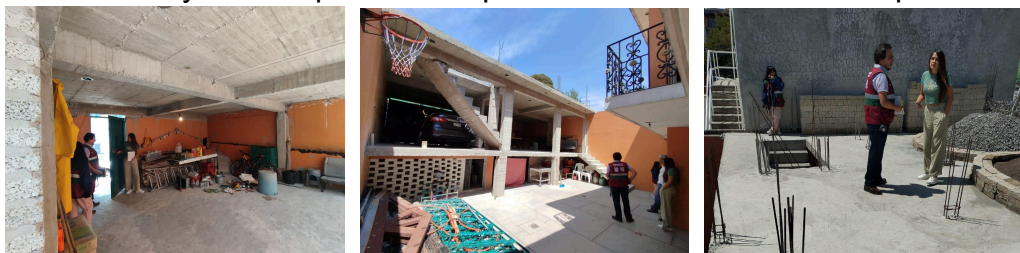
Fig 2. Pre Visita técnica en un domicilio ubicado en la Alcaldía de Tlalpan, en este caso la solicitante ya contaba con un anteproyecto pero violaba el reglamento de construcción específicamente las normas técnicas complementarias capítulo 1 apartado 1. Perfil de las fachadas en la vía pública. 1.1 Elementos que sobresalen al paramento donde no se permite que la construcción abarque hasta la marquesina, (fuente propia).
