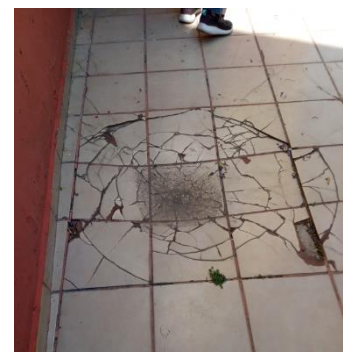
Figura 7. Daño en piso por la caída de campana. [Fotografía]. Fuente: Casiano, D. (2023).
