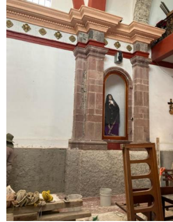
Figura 24. Aplanado con cal-arena en el rodapié al interior de la Capilla. [Fotografía]. Fuente: Casiano, D. (2023).
