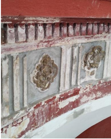
Figura 22. Existencia de daño por la pérdida de material y humedad en las metopas y triglifos. [Fotografía]. Fuente: Hernández, S. (2023).
