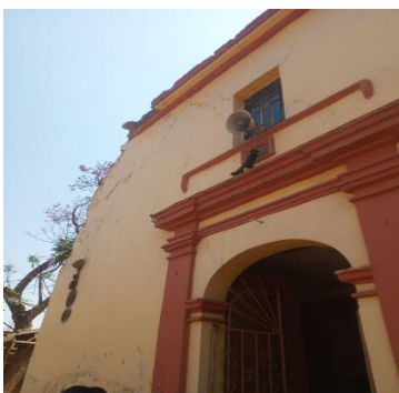
Figura 5. Daño en la fachada de la Capilla. [Fotografía]. Fuente: Casiano, D. (2023).
