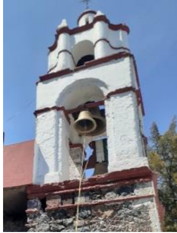
Figura 23. Torre campanario con aplanados en mal estado. [Fotografía]. Fuente: Hernández, S. (2023).
