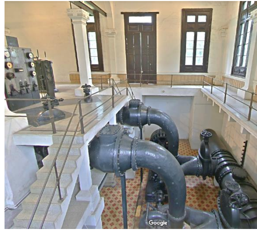
Figura 55. Tubería, válvulas y maquinaria de Bombeo en la Antigua Casa de Bombas No.5. [Fotografía]. Google Maps. (2014).
