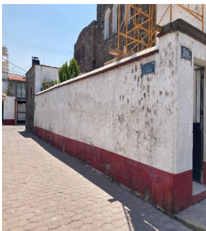
Figura 19. Barda lateral dañada sobre Callejón Las Flores. [Fotografía]. Fuente: Casiano, D. (2023).
