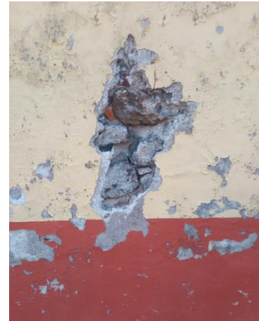
Figura 10. Desprendimiento de material en la Capilla. [Fotografía]. Fuente: Casiano, D. (2023).
