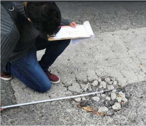
Imagen 1 Levantamiento de baches existentes en estacionamiento UAM-XOCHIMILCO
