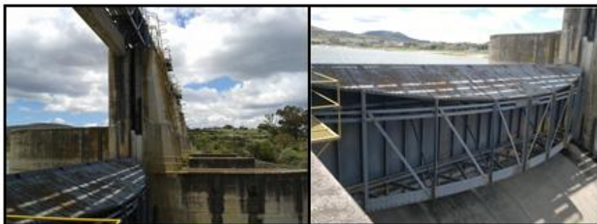
Fotografía 14: Compuerta vertical (vista lado seco).
