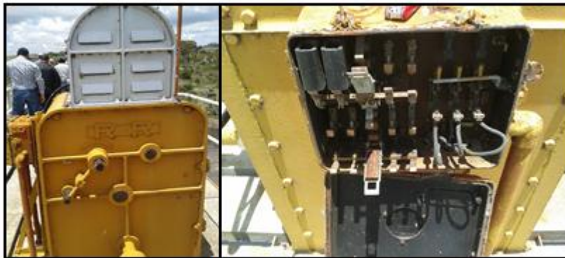
Fotografía 11: Motor de maniobra de una compuerta.
