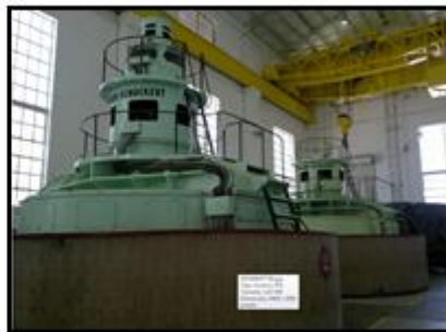
Fotografía 2: Generadores U-2 y U-3.
