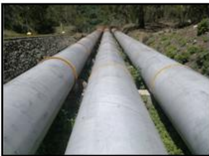
Fotografía 9: Tuberías a presión.
