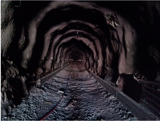
Postes de luz y portal de entrada
