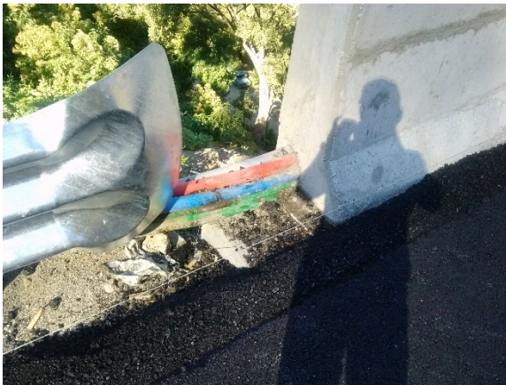
Imagen 3 cableado en puente
