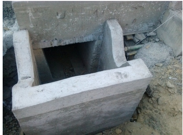
Imagen 4 desfogue de drenaje de agua
