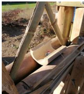
Fotografía 25: Sistema de unión de las armaduras de soporte de la cubierta y los muros
