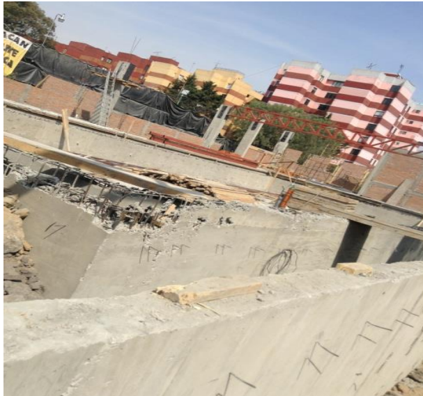
Foto 2. Vista noreste, en esta parte estará ubicado el proyecto de la alberca, haciendo vínculo con la Casa de Cultura
