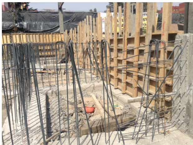
Foto 3. Problemática por dobleces de varillas en el armado
