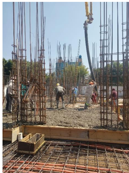
Imagen 5. Colado de la losa. U.H Leyes de Reforma. 29 de febrero del 2024. (Autoría propia).
