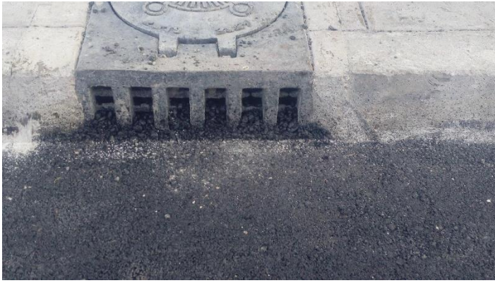
5. Registro de coladera con falla y debe ser corregido.
