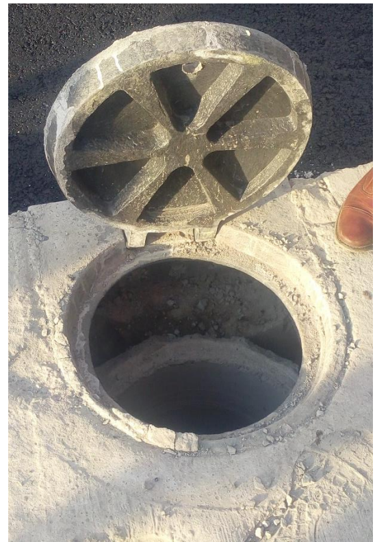
4. Falla en la coladera, no empata con desagüe de la calle.
