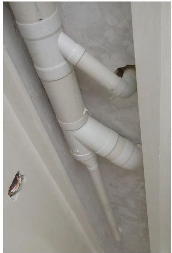
11. Bajadas de aguas negras de W.C. de planta alta.
