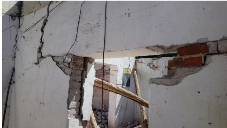
Imagen 1. Terremoto de Ixtepec 1. Casa del vecino de Aidé en ruinas (Irigoyen, 2018)
