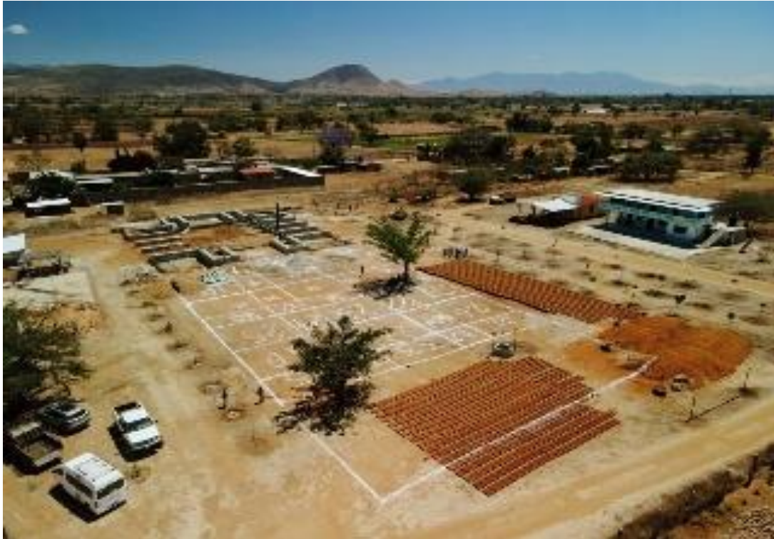
Imagen 5 Trazo de la lotificación y obtención de niveles de la plaza central del proyecto social en la localidad de La Raya, municipio de Zimatlán de Álvarez, Oax.
