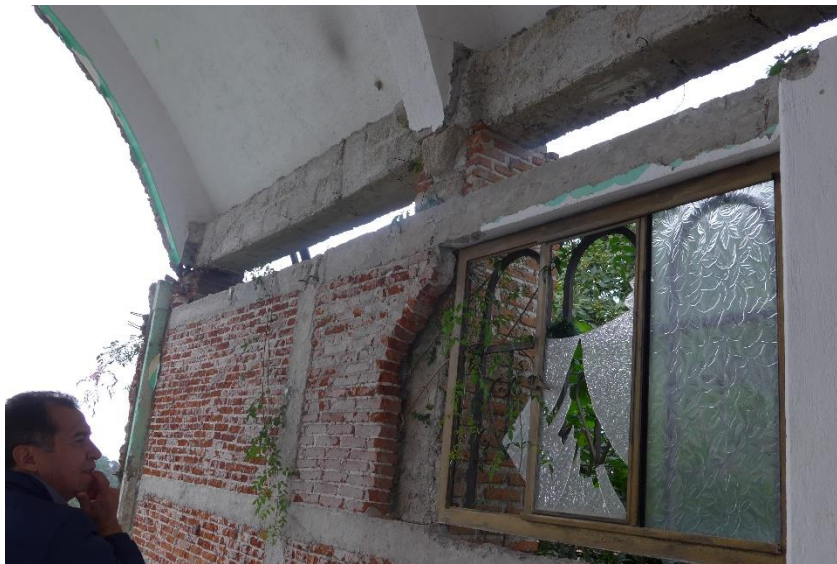
Imagen A.2 daño en la estructura que soporta la cubierta de la capilla
