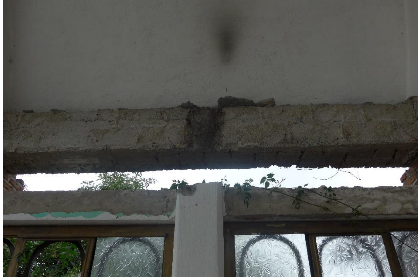
Imagen A.3 desprendimiento de recubrimientos y agrietamiento en muros
