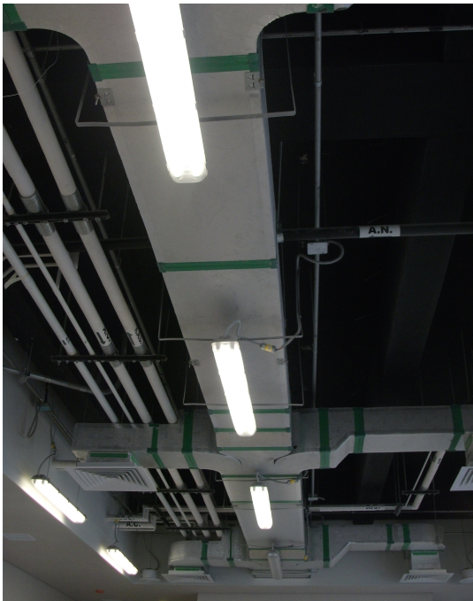
Ductos de aire acondicionado
