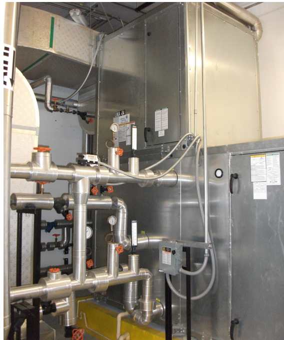
Reguladores de vapor casa de maquinas a/ac
