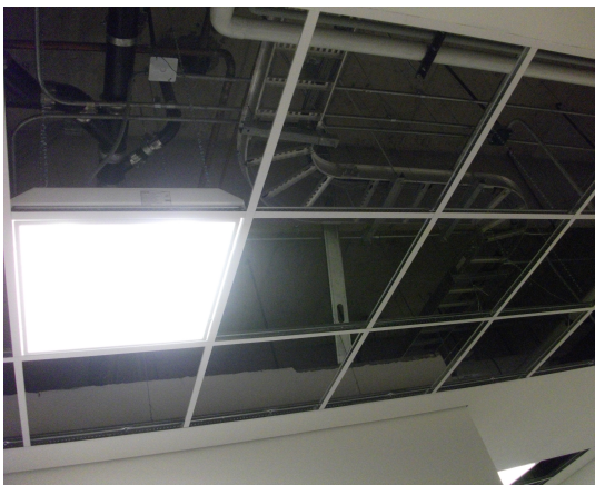
Rejilla tipo escalerilla (voz y datos)
