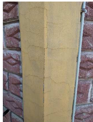
Imagen 9 Grietas en acabado de castillo
