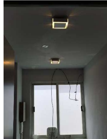
Imagen 22 Instalación eléctrica terminada
