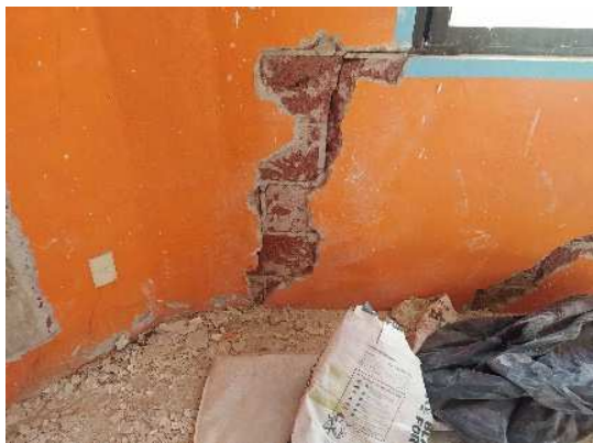
Imagen 15 Fisura y desprendimiento de acabado en pared
