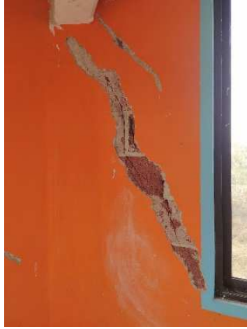
Imagen 11 Fisura y desprendimiento de acabado en pared
