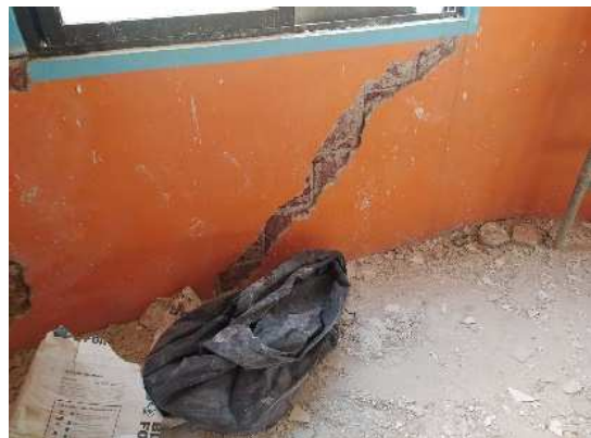
Imagen 16 Fisura y desprendimiento de acabado en pared
