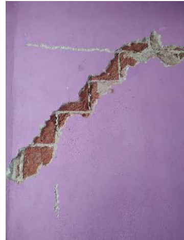
Imagen 6 Desprendimiento de acabado en pared
