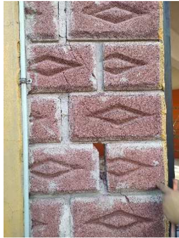
Imagen 2 Grieta en block exterior
