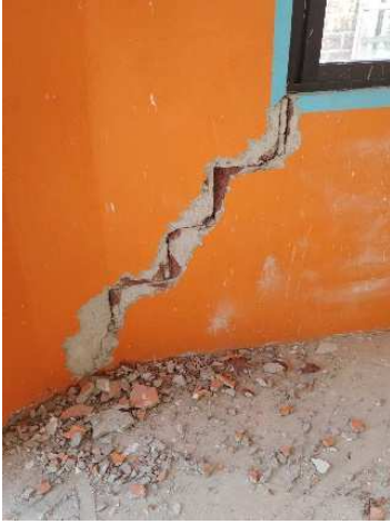
Imagen 10 Fisura y desprendimiento de acabado en pared
