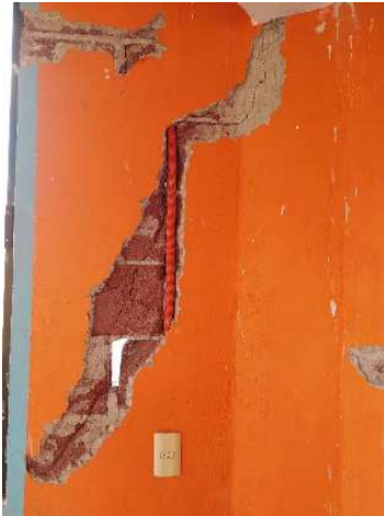
Imagen 1 Fisura y desprendimiento de acabado en pared
