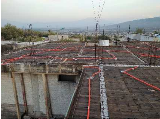
Imagen 19 Techo de vivienda con tubería de instalación eléctrica
