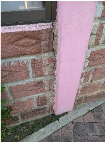
Imagen 4 Grieta entre muro de block y castillo
