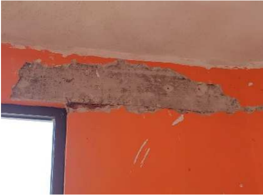
Imagen 13 Desprendimiento de acabado en pared
