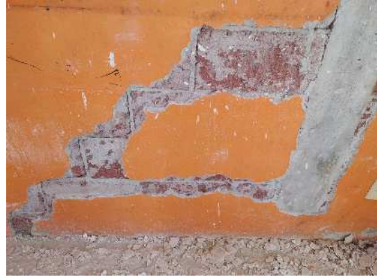
Imagen 14 Fisura y desprendimiento de acabado en pared
