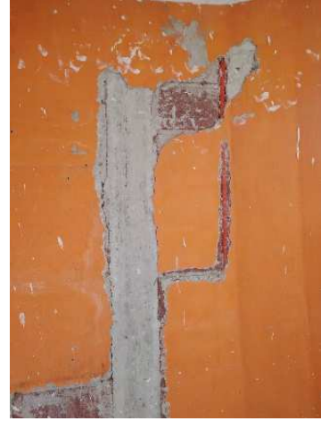
Imagen 12 Fisura y desprendimiento de acabado en pared
