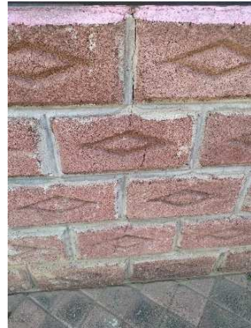
Imagen 3 Grieta en block exterior
