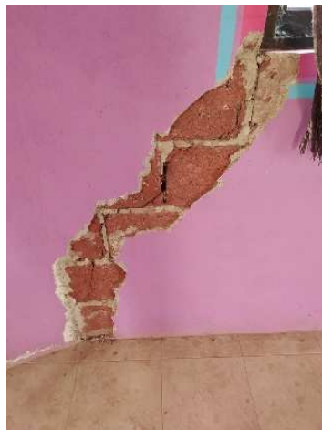
Imagen 8 Fisura y desprendimiento de acabado en pared
