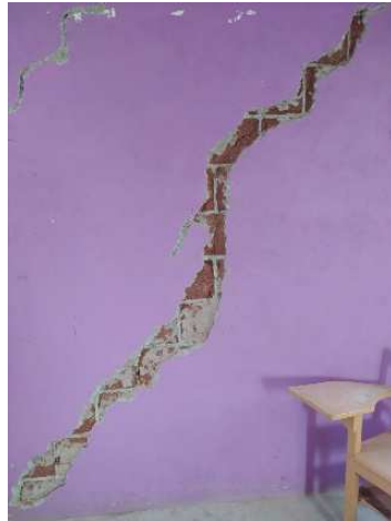
Imagen 5 Desprendimiento de acabado en pared
