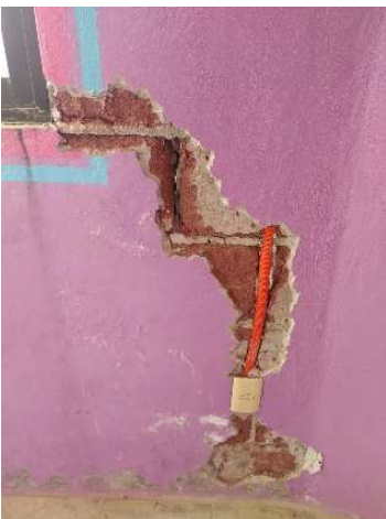
Imagen 7 Fisura y desprendimiento de acabado en pared
